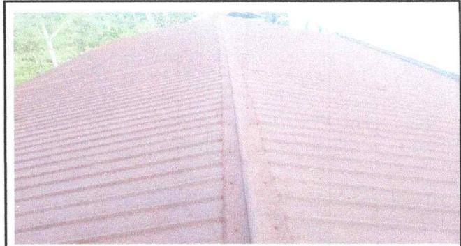
Foto 4: Las láminas del módulo están oxidadas.
